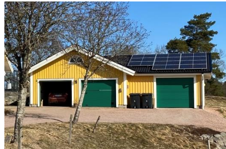
4,12 kW solanläggning (2021) på garage. 4 000 kWh/år
