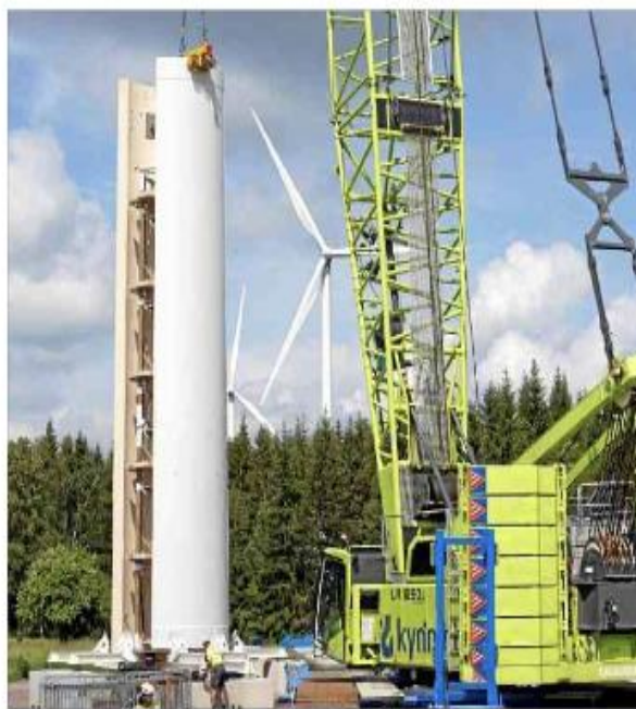
Trämodulerna tillverkas i fabrik och monteras ihop på plats. Sju stycken 15 meter höga sektioner utgör det färdiga tornet.
